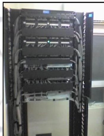
. Cableado estructurado Páginas Amarillas Trujillo.
